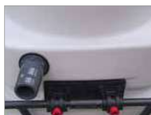
VALVE DE DÉBIT D'EAU
